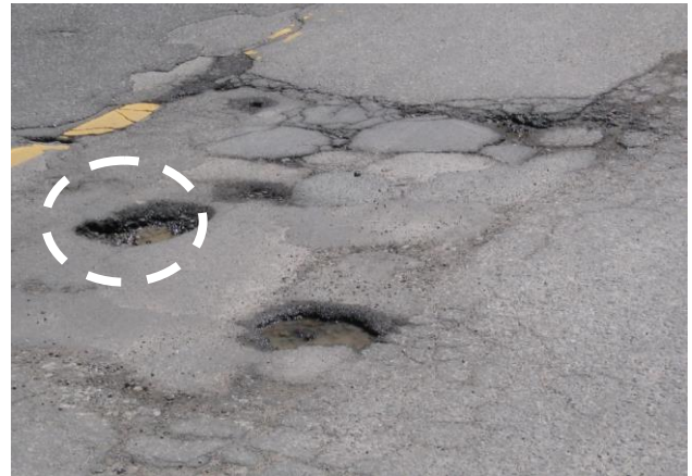
Figure 2. Exemple de plusieurs nids-de-poule dans une zone fortement fissurée. Celui de gauche au centre qui est encerclé n'est relié à aucune fissure du BB.
