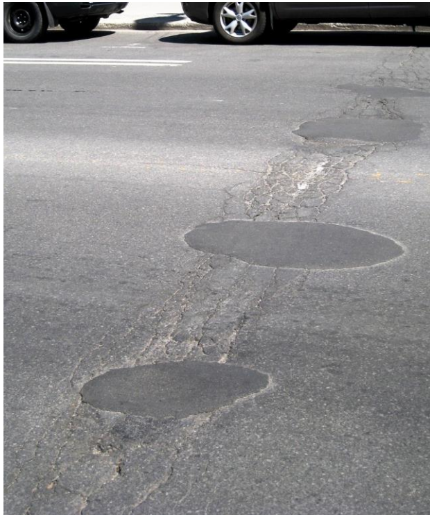
Figure 1. Quatre nids-de-poule réparés dans une zone fortement fissurée autour d'une fissure transversale avec de nombreuses fissures secondaires.
