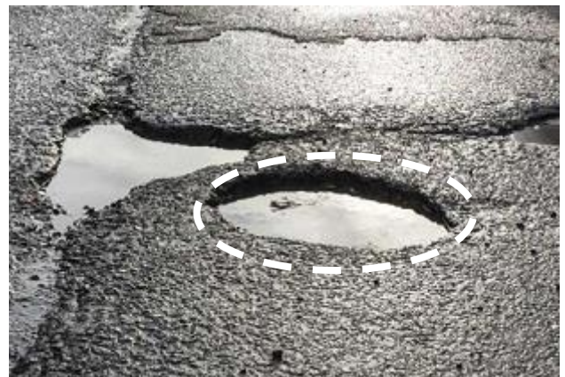
Figure 3. Nids-de-poule pendant l'hiver à Montréal. Celui du centre, encerclé, n'est connecté à aucune fissure.
