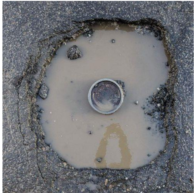
Figure 4. Nid-de-poule en cratère formé autour d'un tuyau vertical.
