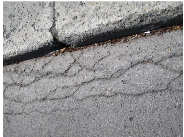
Figure 10. Fissuration concentrée le long d'un trottoir.
